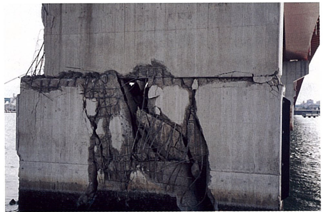
被災したP6橋脚
