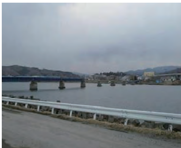
写真 2.2.37 橋桁流出（第34閉伊川橋りょう）
