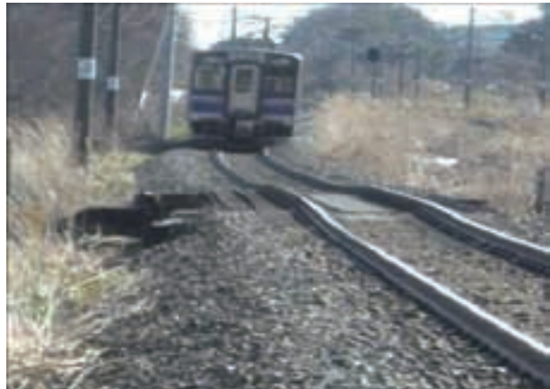
写真 2.2.5 軌道の変位（村崎野駅～花巻駅間）
