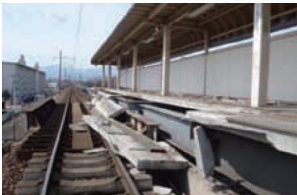
写真 2.6.3 福島学院前駅ホーム崩落
