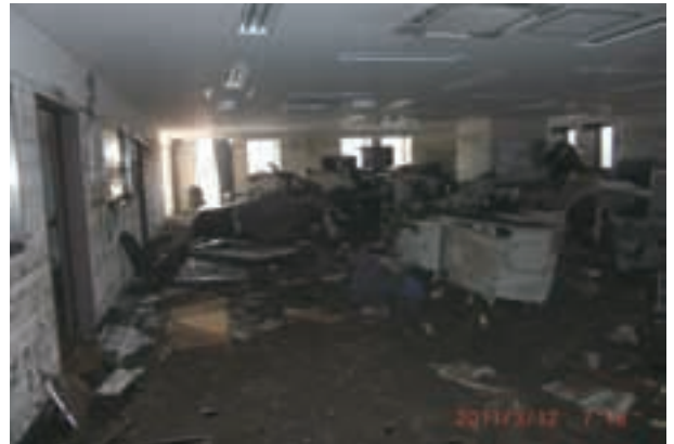
写真 2.4.6 津波によって破壊された指令室の惨状
