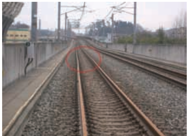
写真 2.5.8 横方向に変位した軌道
