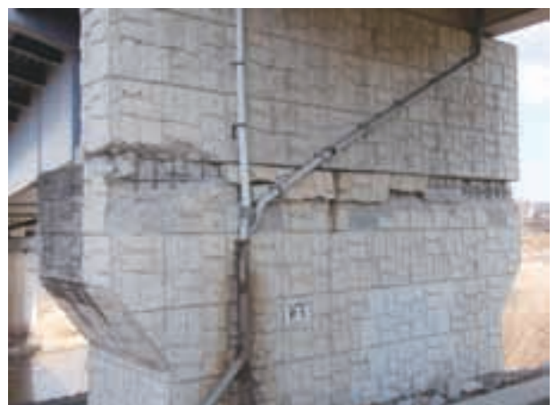
写真 2.5.3 七北田川橋りょうの損傷状況
