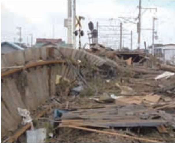
写真 2.2.9 線路の流失（山下駅）
