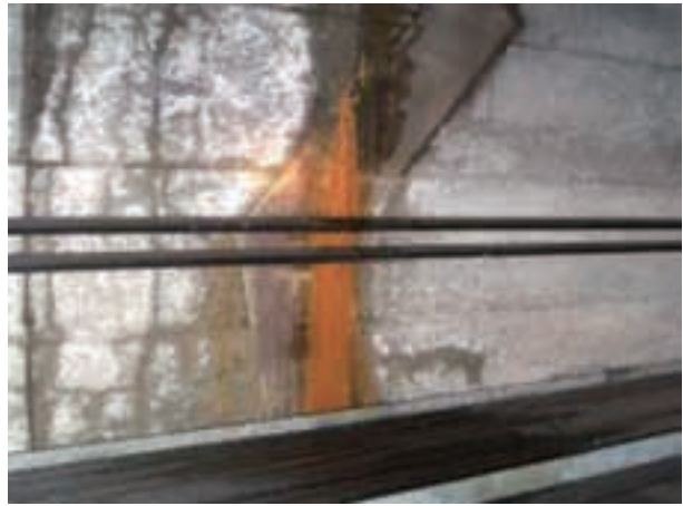
写真 2.5.7 トンネル内の漏水状況
