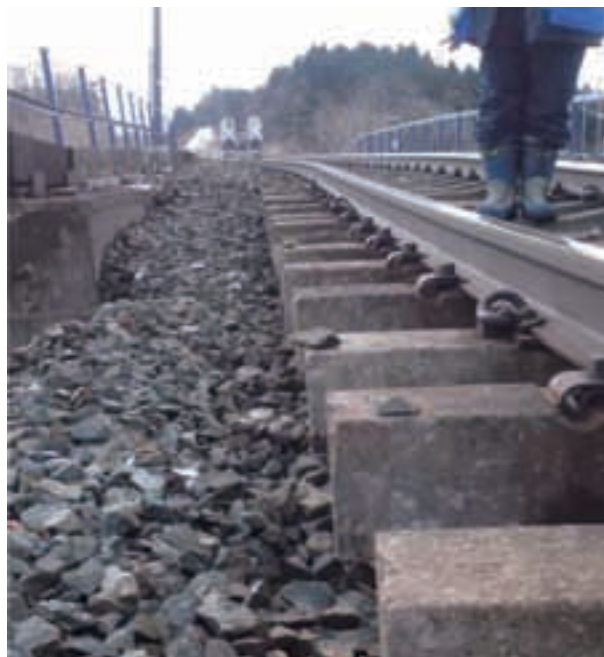
写真 2.7.1 滝沢駅～洪民駅間道床流失状況
