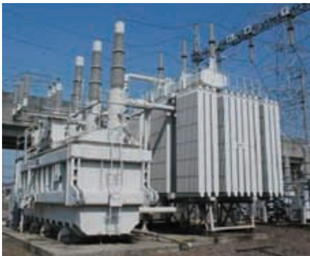
写真 2.1.31 変電所の特高変圧器の全景
