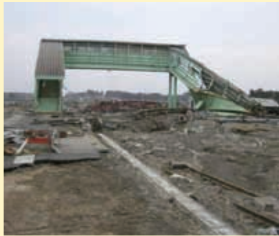
写真 2 震災後の流失した新地駅
