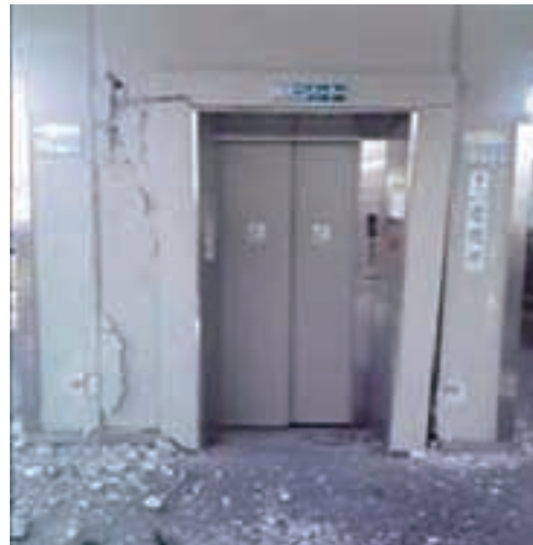
写真 2.1.18 エレベータ搭屋三方枠他破損（福島駅）
