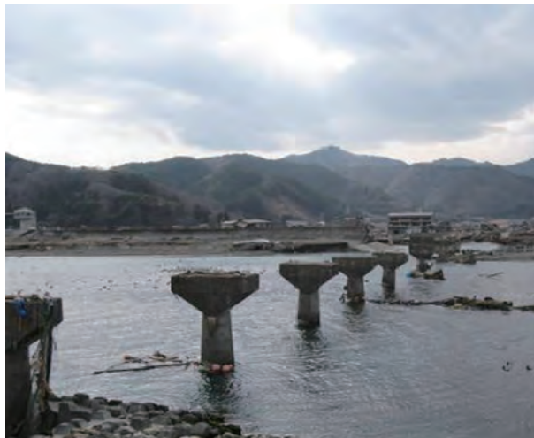
写真 2.2.38 橋桁・橋脚流出（大槌川橋りょう）
