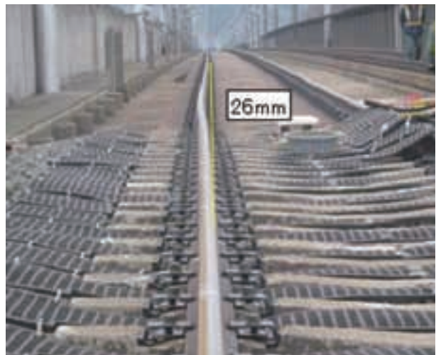
写真 2.1.9 軌道の変位(新白河駅構内)
