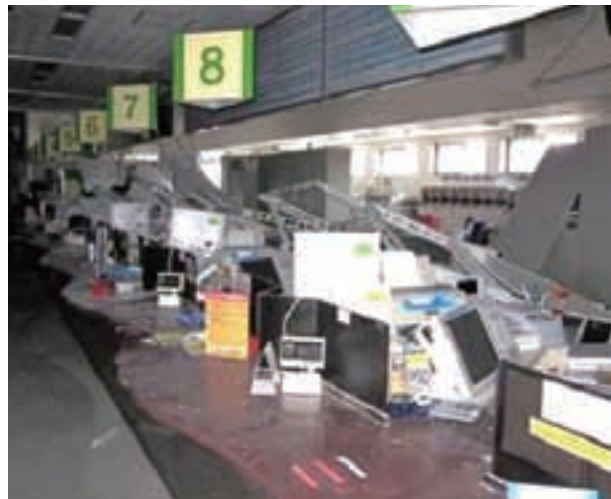
写真 2.1.19 みどりの窓口内破損状況（仙台駅）
