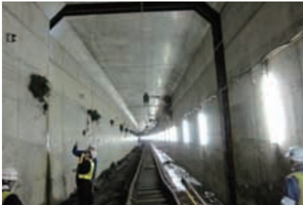
写真 2.4.4 トンネルボックス相互間の相対変位と軌道の変状
