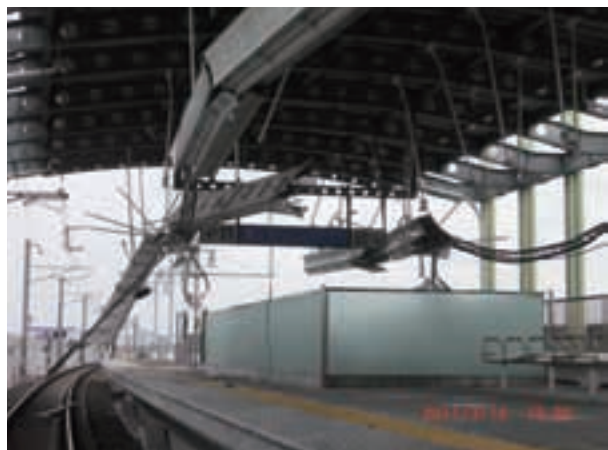
写真 2.4.5 照明ラックが垂下したホーム（杜せきのした駅）
