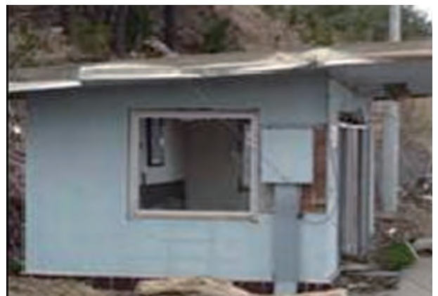
写真 2.2.28 駅舎損傷（有家駅）
