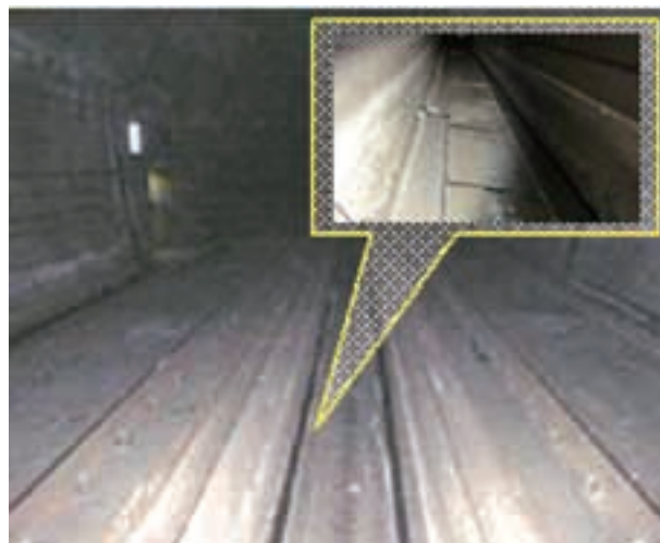
写真 2.1.13 路盤の隆起・変状
