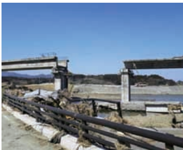
写真 2.2.22 橋桁の流失(陸前小泉駅～本吉駅間)
