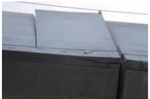
写真 2.4.3 亀裂が入り、落下する危険のある防音壁
