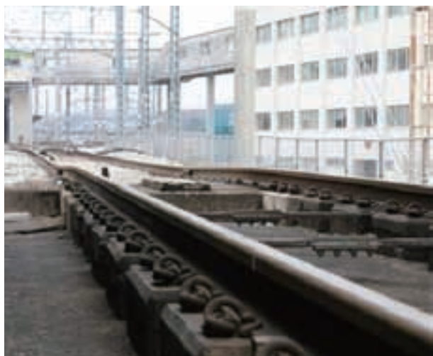
写真 2.1.38 軌道の変位（新幹線総合車両センター）
