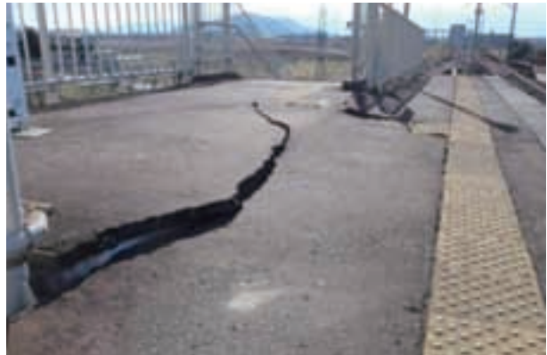
写真 2.6.4 向瀬上駅ホーム亀裂
