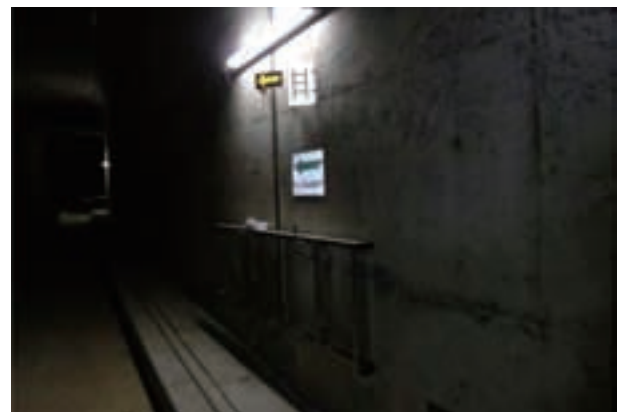
写真 2.4.12 トンネル内照明灯の下に設置された出口誘導表示板と非常用ハシゴ
