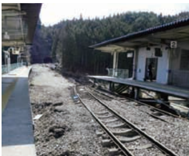
写真 2.2.21 線路の流失(歌津駅構内)
