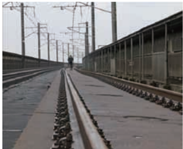
写真 2.1.10 軌道の変位(仙台駅~古川駅間)
