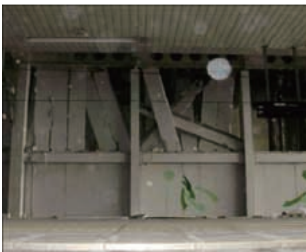
写真 2.1.17 ホーム階段室 ALC 崩壊
