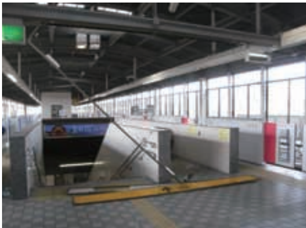
写真 2.5.10 案内掲示器等の脱落状況
