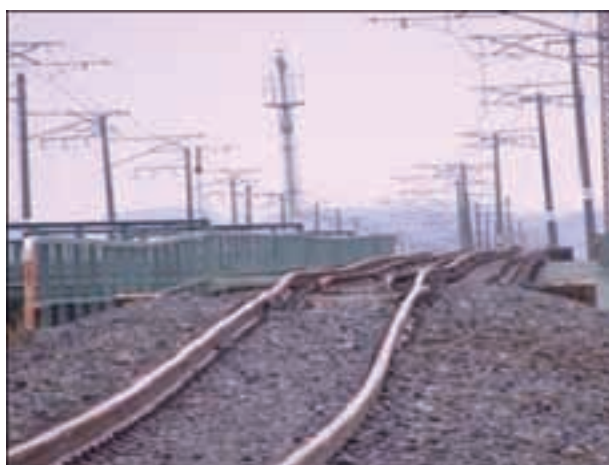
写真 2.2.49 橋桁の沈下（小牛田駅構内）
