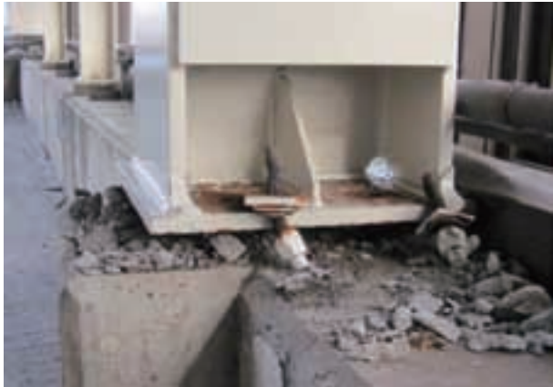
写真 2.5.4 八乙女駅の上屋支柱を固定しているアンカーボルトの破断状況
