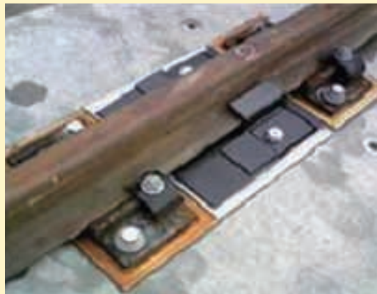
写真4 レール転倒防止装置
