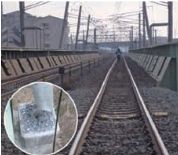
写真 2.2.7 電化柱の損傷（岩切駅構内）
