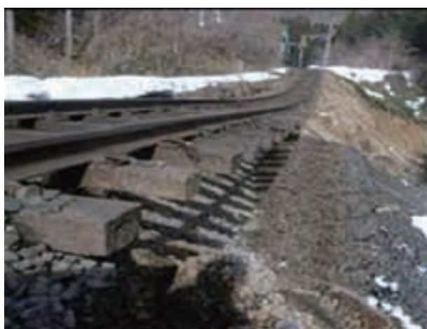
写真 2.2.48 盛土の崩壊（仙山線）
