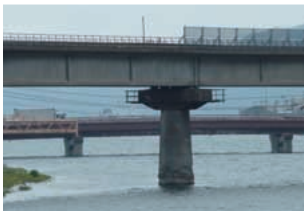
写真 2.3.6 (1) 亀裂が入った大渡 へいた 川 へいた 橋梁橋脚
