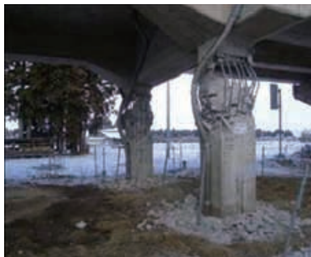
写真 2.1.14 高架橋柱の損傷 (北上駅～新花巻駅間)
