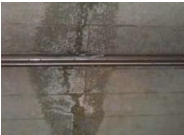
写真 2.5.6 トンネル内の漏水状況
