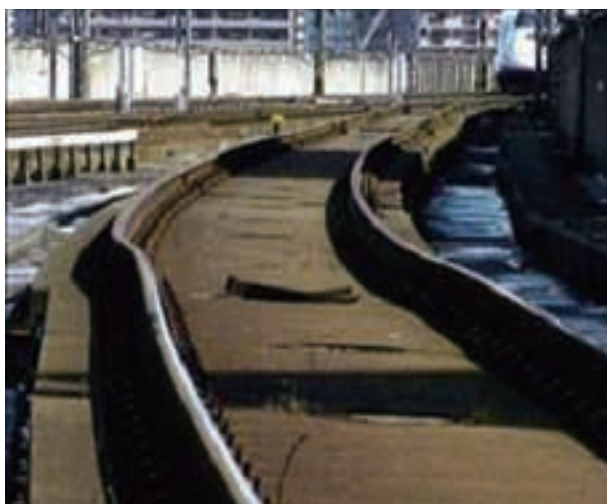
写真 2.1.12 軌道の変位 (仙台駅構内)
