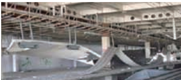
写真 2.1.16 仙台駅天井仕上げ材の落下
