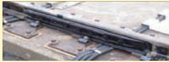
写真3 地震対策用接着絶縁継目
