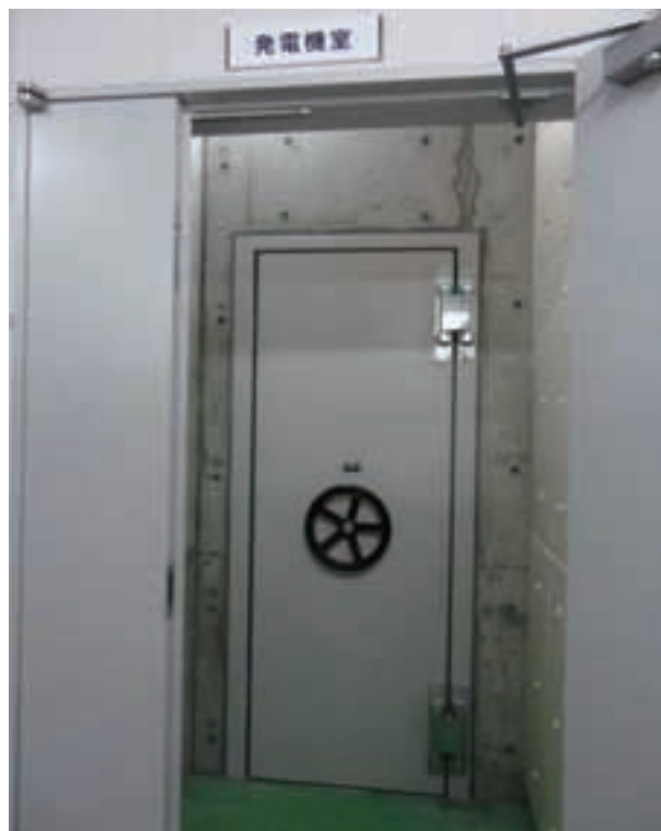
写真 2.4.9 津波対策を施した非常用発電機室の二重扉と防水壁（空港駅1階）
