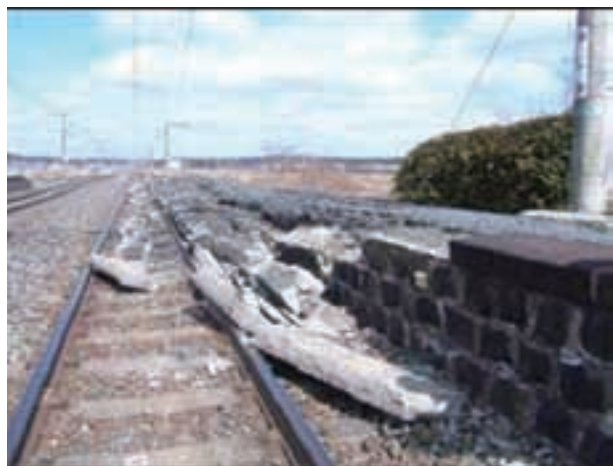
写真 2.2.6 ホームの変位（油島駅構内）
