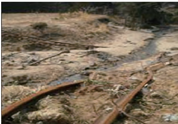
写真 2.2.26 線路流失（有家駅～陸中中野駅間）
