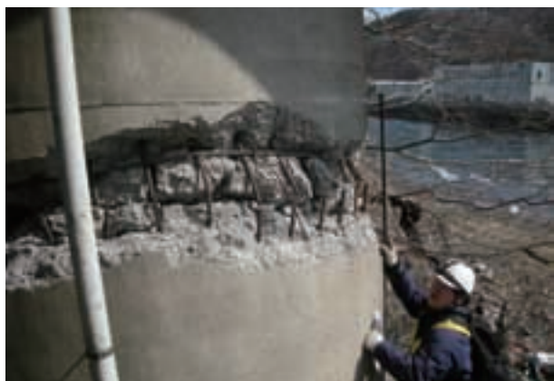
写真 2.3.6 (2) 亀裂が入った大渡川橋梁橋脚
