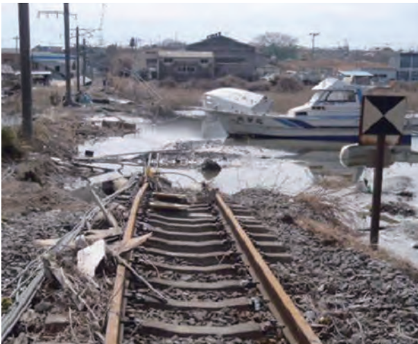
写真 2.2.13 線路の流失(東塩釜駅～陸前浜田駅間)
