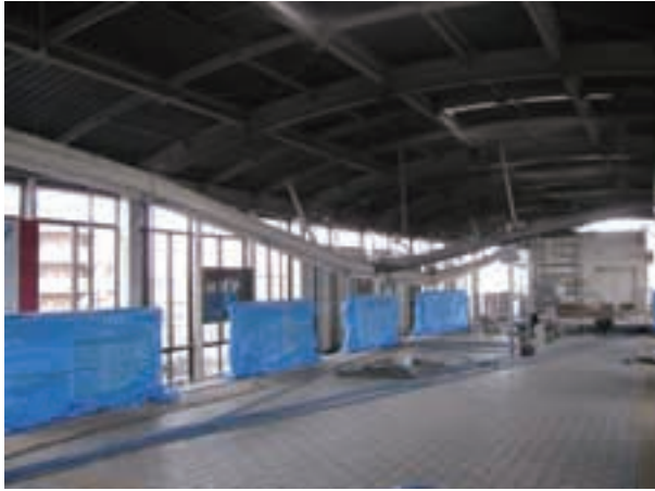
写真 2.5.9 照明器具の損傷状況
