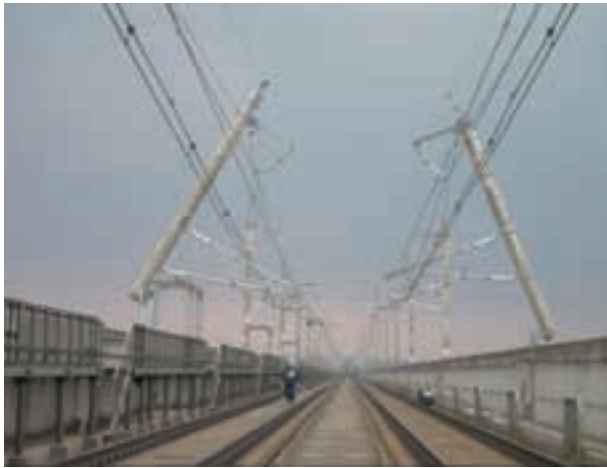
写真 2.1.15 電化柱の折損（水沢江刺駅～北上駅間）
