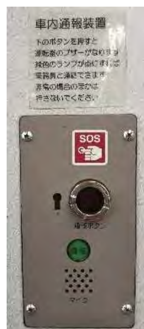
車内通報装置（車両側）
