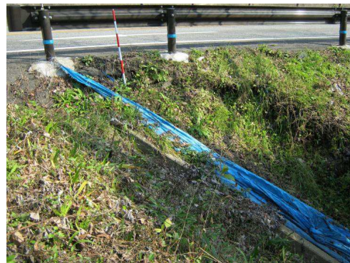
のり面の浸食
