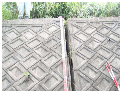
擁壁目地の開口
