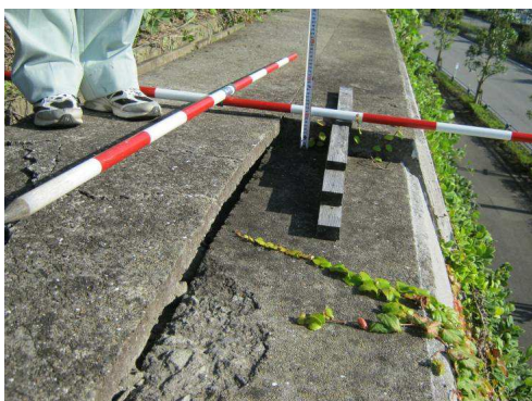
擁壁天端の段差
