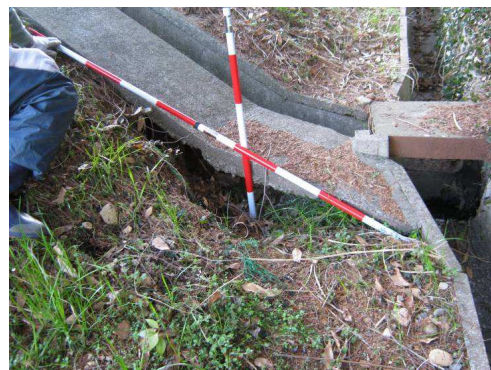
排水路基礎の洗掘
