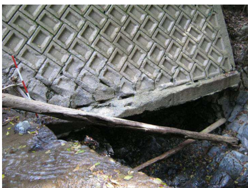
擁壁基礎の洗掘
