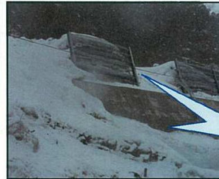
道路への雪崩流出
