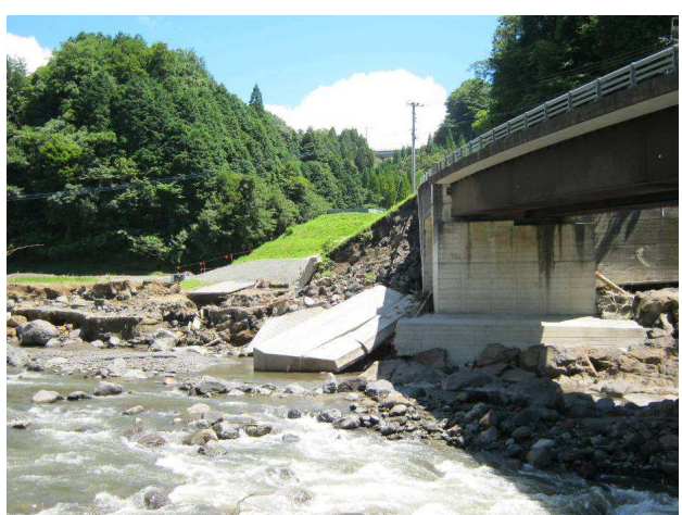
倒壊した橋台取付部の擁壁
