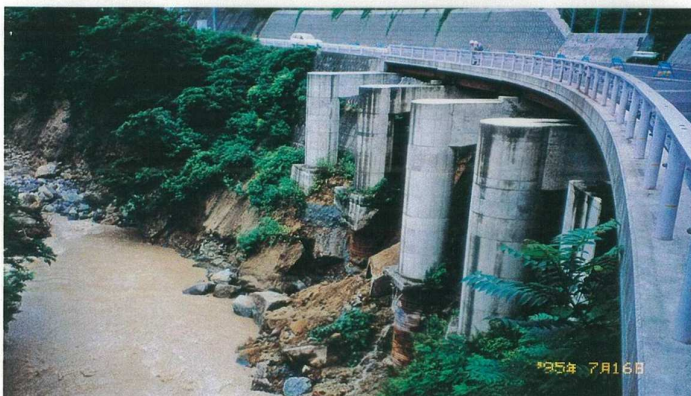
溪岸が浸食を受け、橋脚基礎杭が洗掘により露出 ⑧-7
