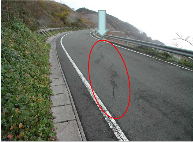
路面に認められる盛切り境界のクラック
