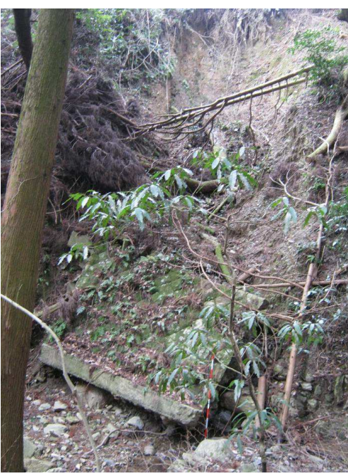
倒壊した道路下の擁壁 流末処理の不適切
