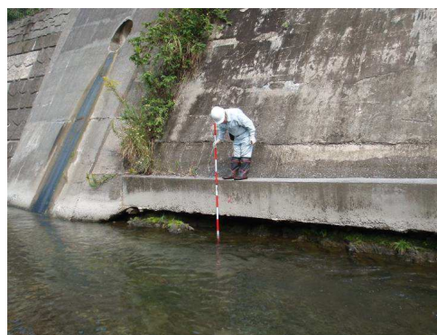
擁壁基礎の洗掘
