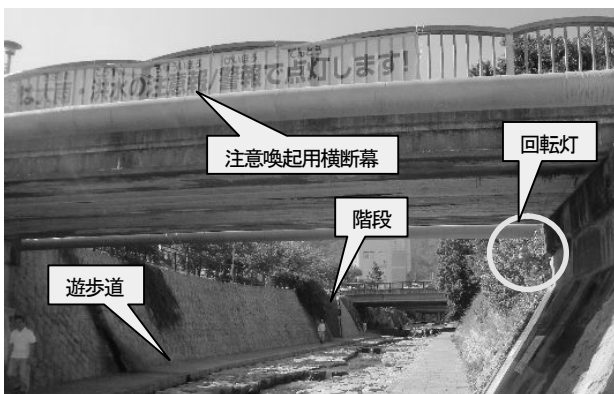
写真-1 増水警報システム(回転灯)の設置状況
