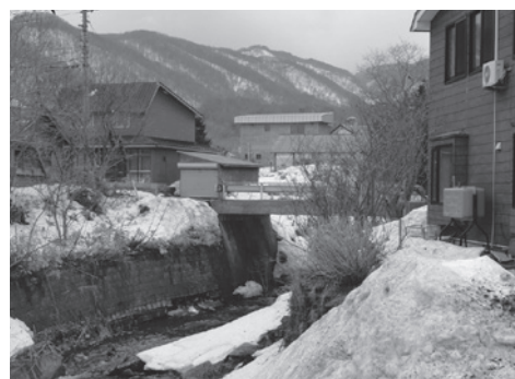
▲新甫川。右岸積ブロック護岸の下段部分が崩れ落ちている
