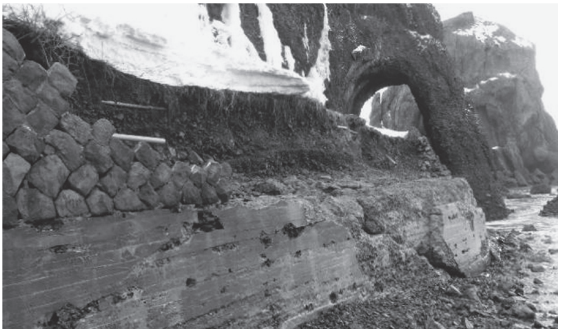
▲厚瀬トンネル横の断水現場。旧国道の石積擁壁が高波に洗われ、埋設されていた配水管が流失。残された配水管の一部が露出している。
