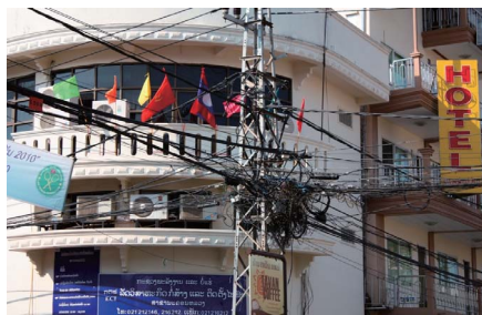
電線がスパゲティ状に絡まっていて、送電効率を落としている。
