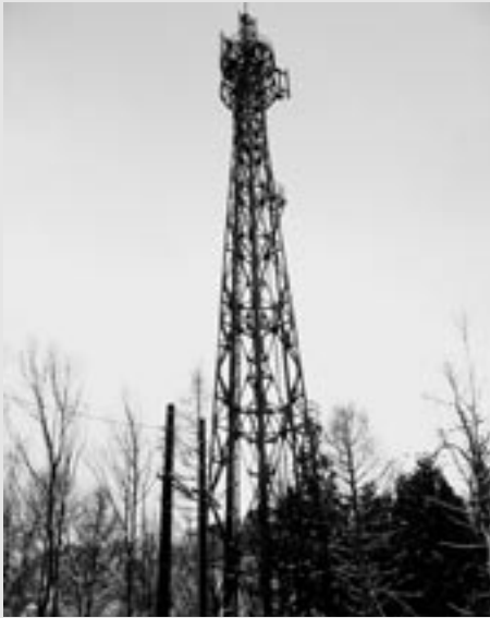
完成した携帯電話無線局
