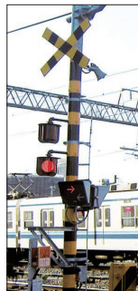
△更新されたせん光灯
