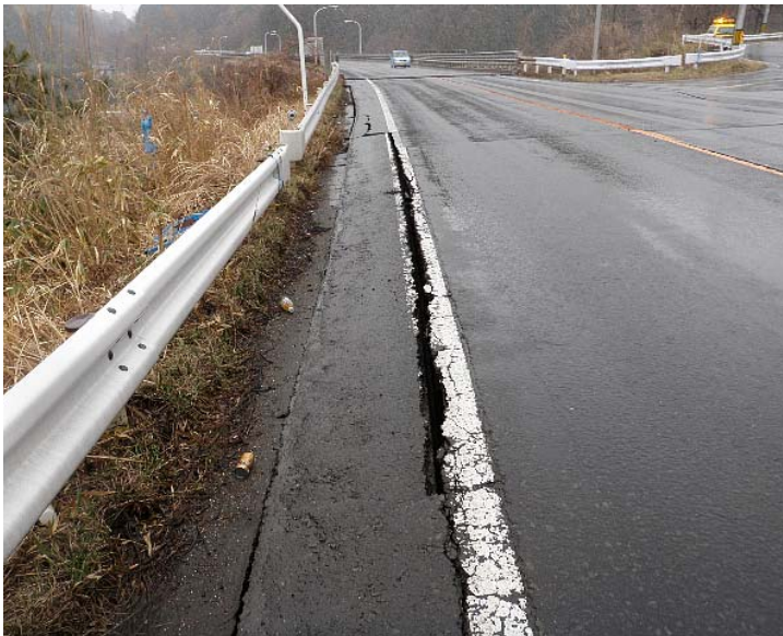
▲③白石市齊川字御所館地内
