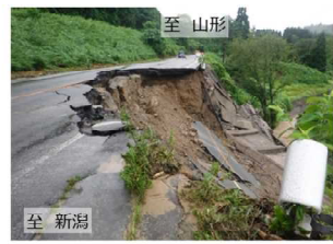
▼R4.8豪雨における被災状況
