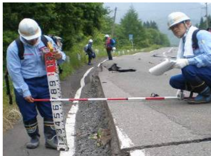
岩手県一関市 国道342号の被災状況調査
