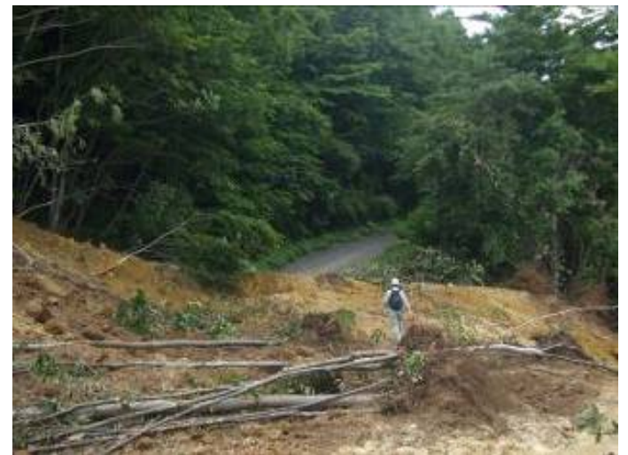
(市)馬場駒ノ湯線 宮城県栗原市日影森地内 【土砂崩落現場】
