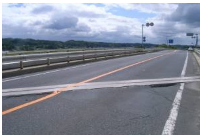
一般国道47号(宮城県大崎市岩出山地内) 【岩出山こ線橋に7~8cmの段差発生】 ・発生直後から片側交互通行
