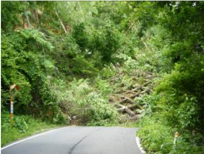
(主)築館栗駒公園線 宮城県栗原市柳沢地内 (行者滝付近) 【土砂崩落現場】
