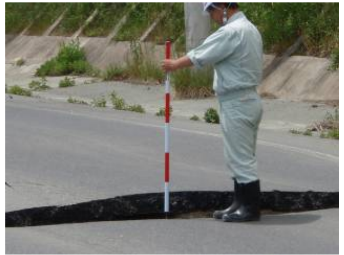
国道397号 秋田県東成瀬村地内 【15日 路面段差・亀裂の調査】
