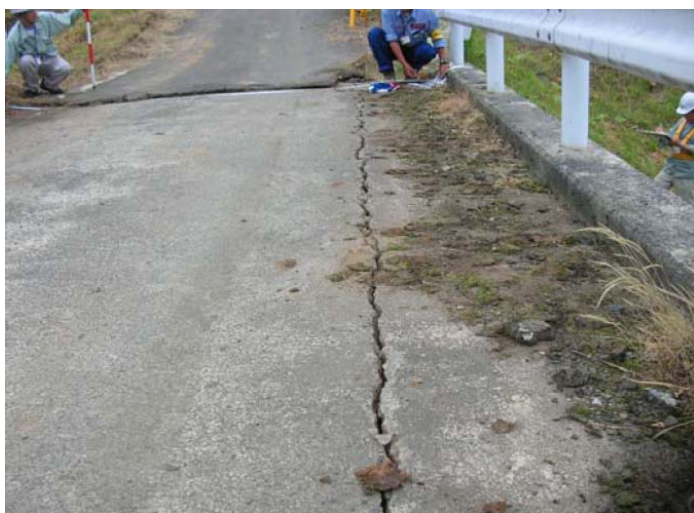
宮城県栗原市 橋梁被災状況調査
