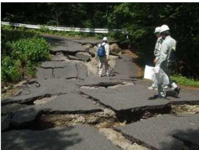
(市)馬場駒ノ湯線 宮城県栗原市日影森地内 【路面損傷現場】
