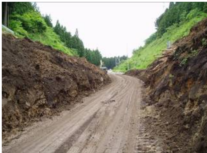
国道398号 宮城県栗原市松ノ原地内 法面崩落 【16日 1車線確保】
