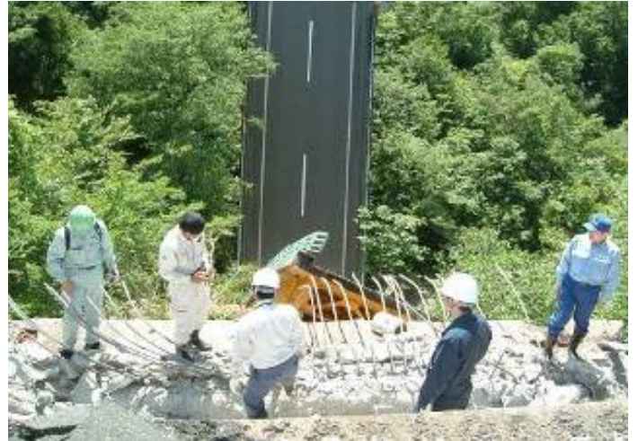
岩手県一関市巖美町地内 【祭時(まつるべ)大橋落橋現場】 TEC-FORCEによる現地調査の状況
