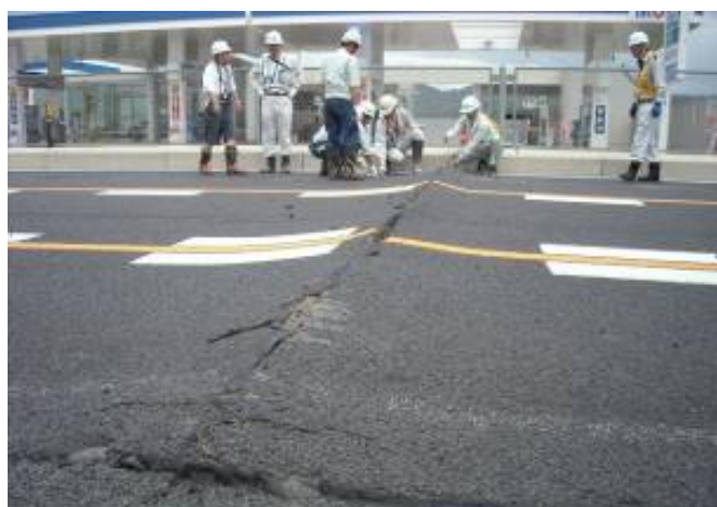
一般国道112号(山形県東村山郡中山町) 【上り線に15cm程度の舗装隆起、 下り線に舗装段差が発生】 ・発生直後から上り線全面通行止め、下り線1車線規制。
