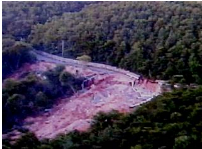
(主)築館栗駒公園線 宮城県栗原市柳沢地内 【路面崩落現場】
