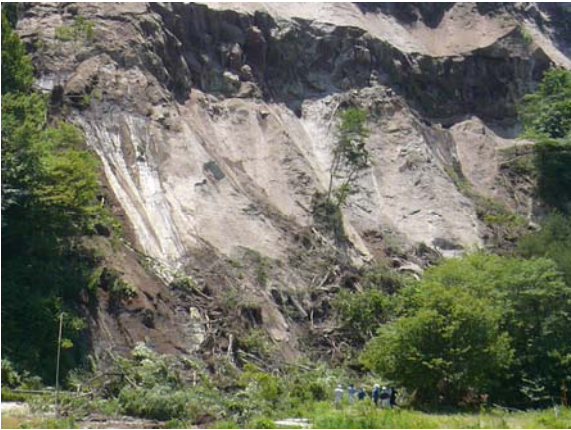
栗原市花山中村地内 国道398号付近治山工事現場。 作業員3名死亡。(14日撮影)
