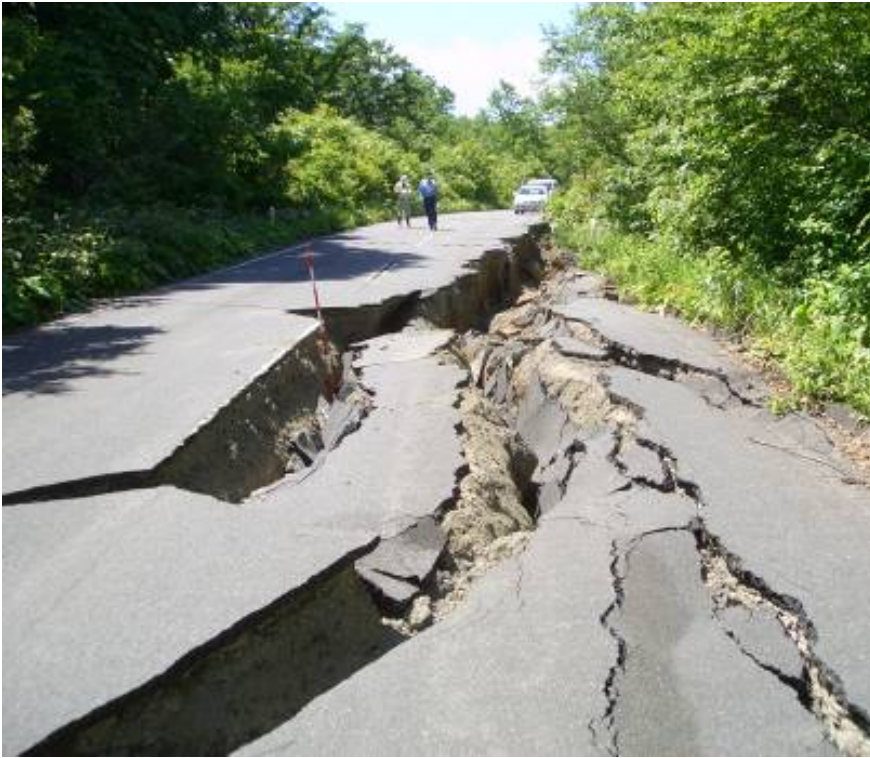
ゆはまとうげ 宮城県栗原市湯浜峠付近 【路面損傷現場】
