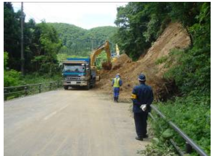
国道342号 岩手県一関市巖美町天王地内 【15日 崩落土砂撤去作業開始】
