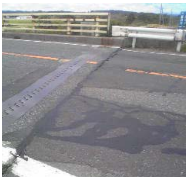
一般国道4号(宮城県栗原市築館地内) 【新荒瀬橋に5~7cmの段差発生】 ・発生直後から徐行により通行可能
