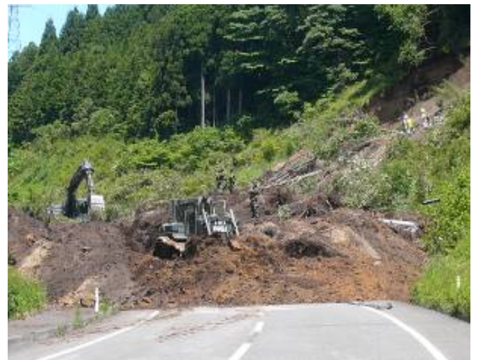
国道398号 宮城県栗原市花山小川原地内 土砂崩落 【19日 崩落土砂撤去作業開始】
