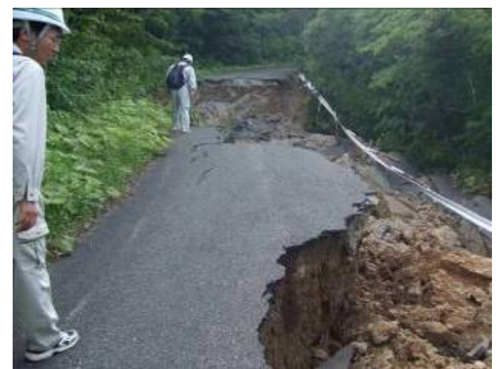
(市)馬場駒ノ湯線 宮城県栗原市日影森地内 【路面崩落現場】
