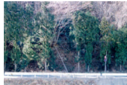
落石・岩石崩壊の危険性が高く、通行規制を強いられる可能性が高い状況
