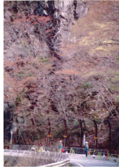
落石等による交通事故発生危険性が高い状況
