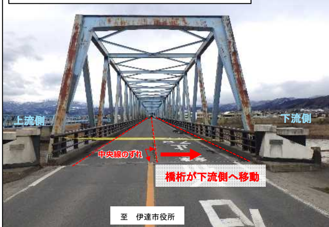
被災した伊達橋（伊達市役所側）（2022. 3. 19）
