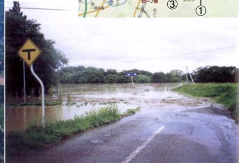
②狐禅寺観測所付近県道浸水状況(一関市)
