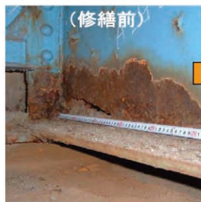
主桁鋼材腐食(橋梁)
