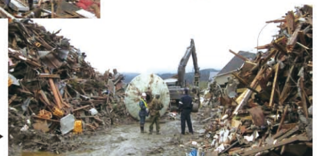
津波により災害を受けた岩手県陸前高田市内の道路啓開状況
