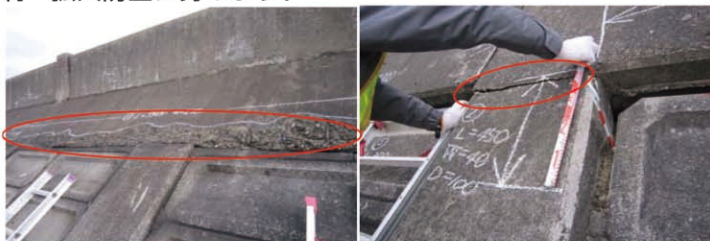
護岸コンクリートの劣化状況
