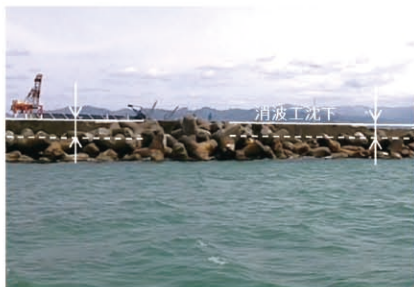
▲老朽化による消波工の沈下 (秋田港)
