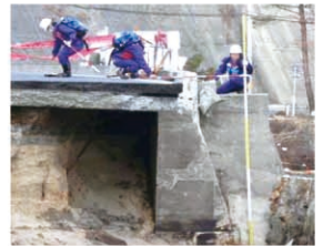
TEC-FORCEによる被災状況調査
