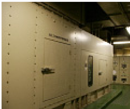
通信局舎に設置した発電機
