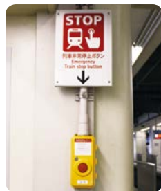
列車非常停止ボタン
