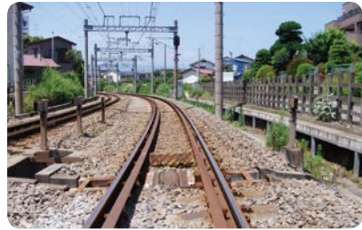
脱線防止ガードレール
