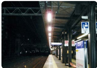
平沼橋駅ホームのLED照明
