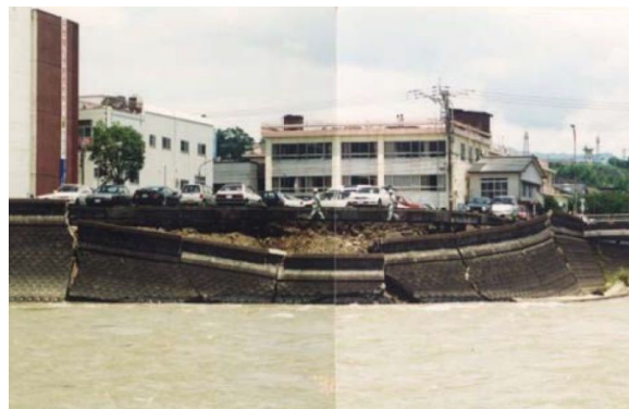
図 2.19 基礎洗掘により崩壊した護岸
