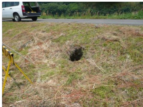
図 2.18 堤防陥没の発見箇所
