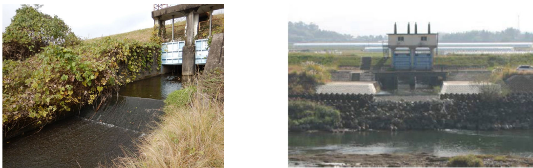
図 5.18 樋門流入口の段差状況
