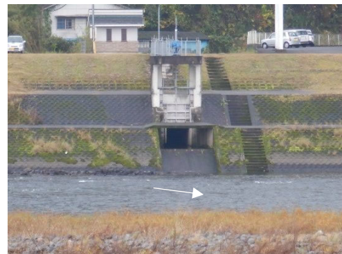
図 2.49 樋門の段差状況
