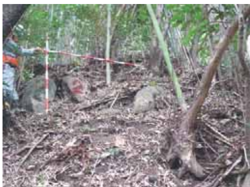
国道202号H8防災点検箇所(唐津市北波多) 急斜面に表層崩壊の跡が生じており、崩壊に伴う転石や浮石化の恐れがある岩が認められる。
