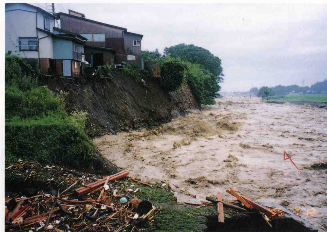
護岸決壊により人家の基礎部まで崩落(新井市姫川原)
