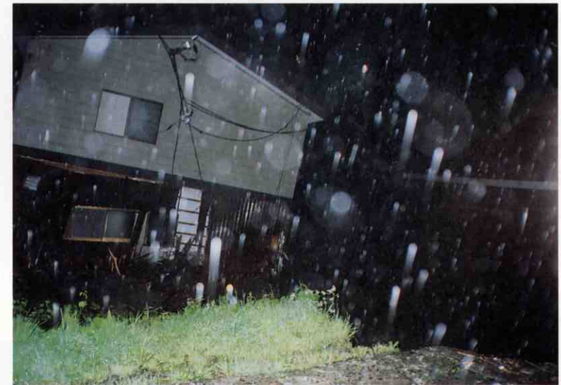
地盤が洗掘され傾く(H7.7.11.22:30)
