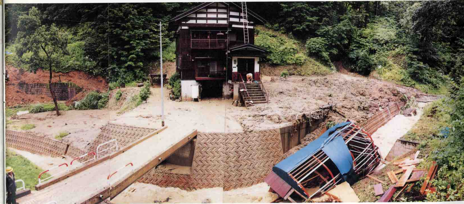
地すべりにより車庫が倒壊(東頸城郡松代町千年)
