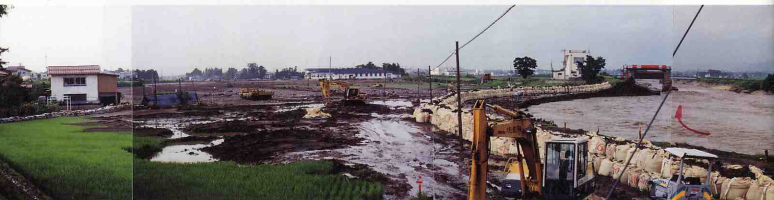
懸命の応急仮工事を実施した破堤箇所(新井市月岡)
