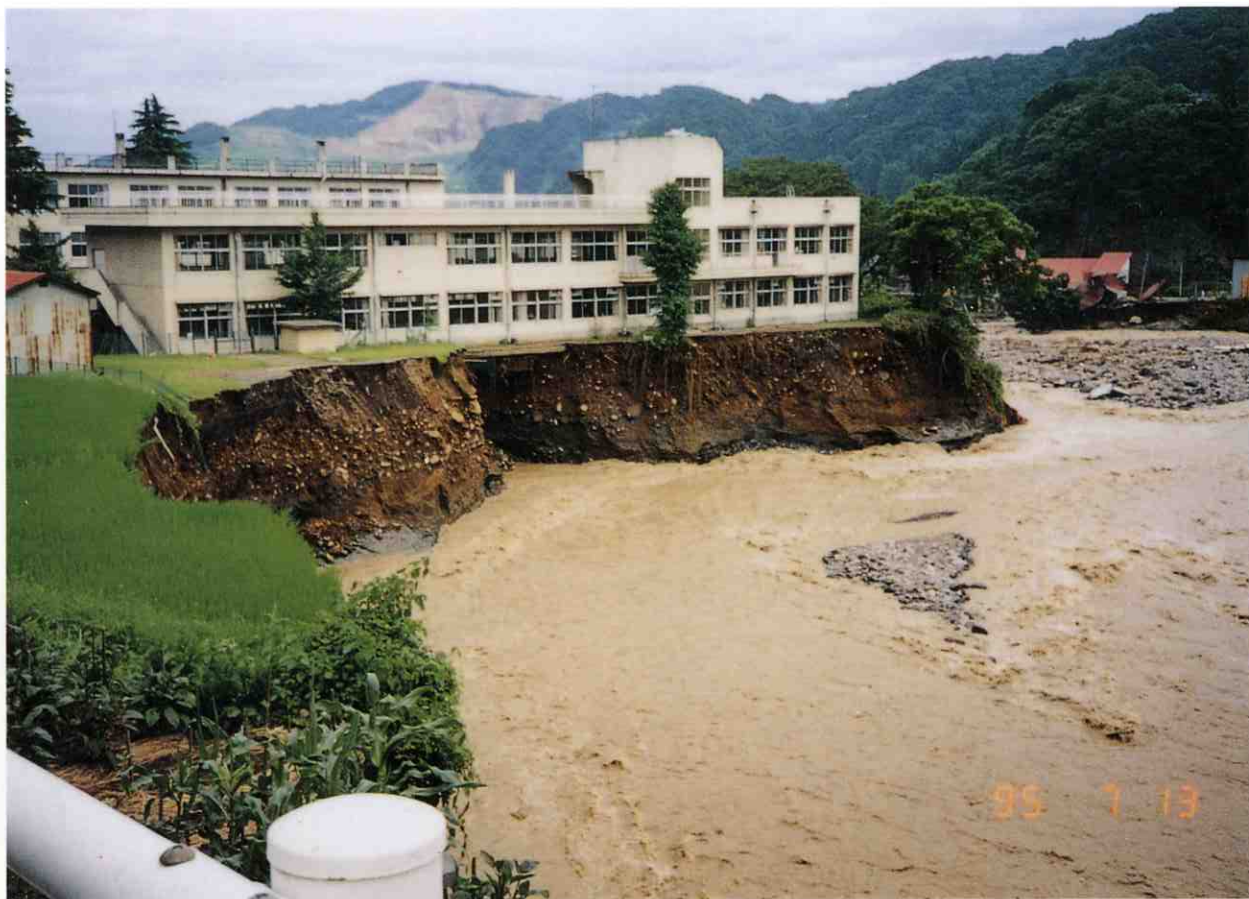
中学校のプールが流され校舎も危険にさらされた。(新井市除戸)
