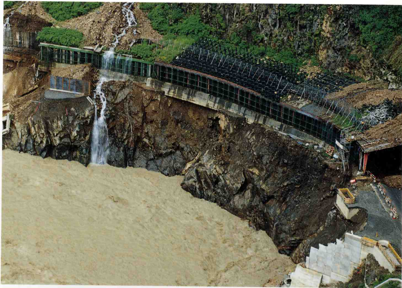
基礎部が洗掘され崩落した国道148号突付洞門(糸魚川市山之坊)
