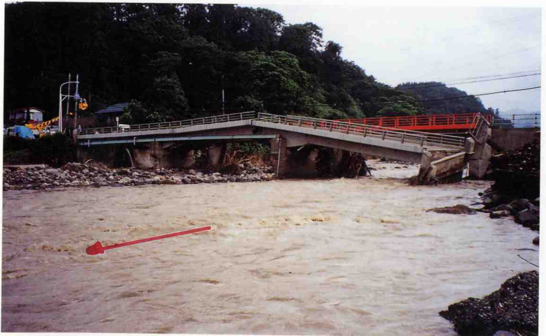
落橋した国道292号猿橋
