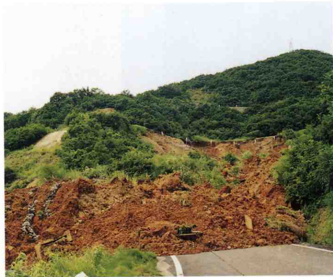
栃尾守門線で法面崩壊し、道路が決壊(守門線村須原)
