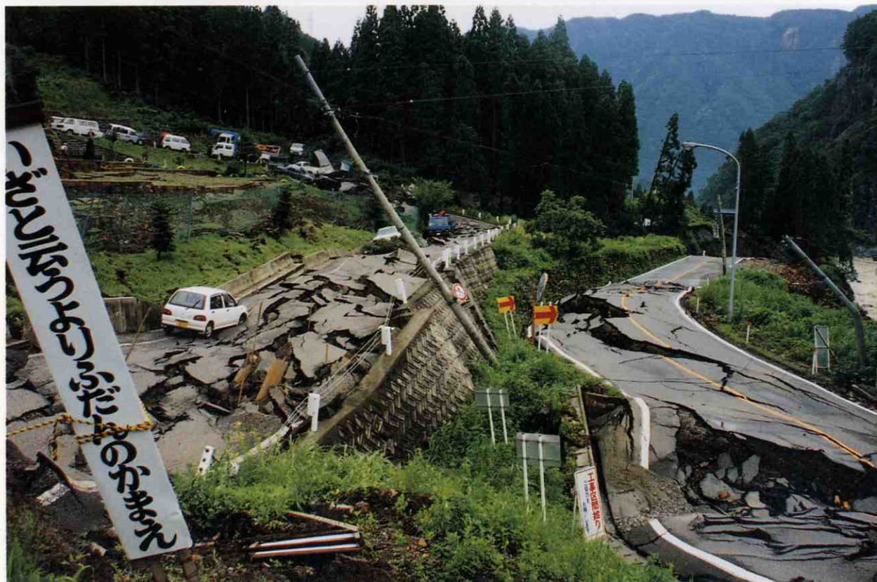
山之坊地すべりの末端部に発生した地すべりは路面の崩壊が次第に拡大し、通行不能となった国道148号と県道山之坊大峰小滝線(糸魚川市平岩)
