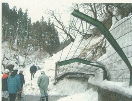
【H18 雪崩発生状況】
