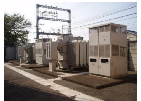
現在の海老名変電所
