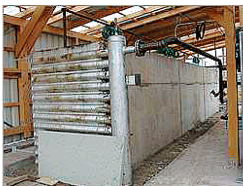
図 5-40 コンクリート蓄熱システム（ドイツ航空宇宙センター実験設備）
