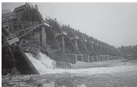
写真-5 石岡ダムの被災状況
