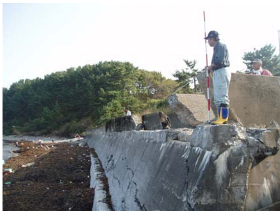
老朽化に伴う海岸保全施設の破損(岩手県玉川海岸)
