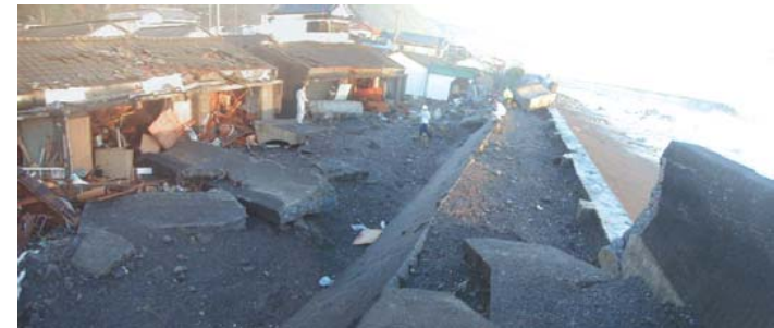
■堤防の被災状況(左)3名が亡くなった住宅(右)倒壊した堤防
