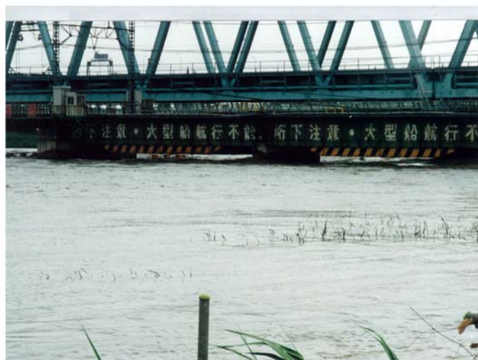
写真 4-12 形成押上線橋梁の洪水写真
