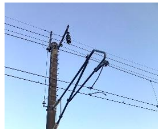
架線金具等の損傷
