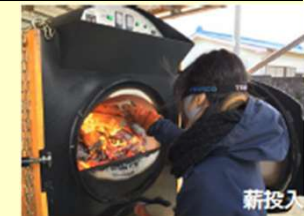
薪投入 木材の燃焼
