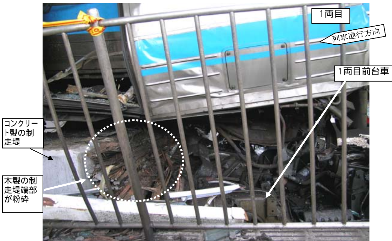
写真 1 2 線路終端車止めの損傷状況
