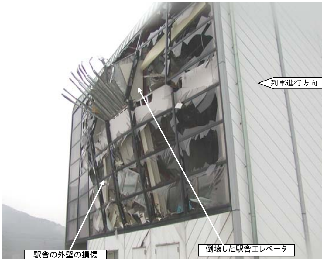
写真 1 1 鉄道施設の損傷状況
