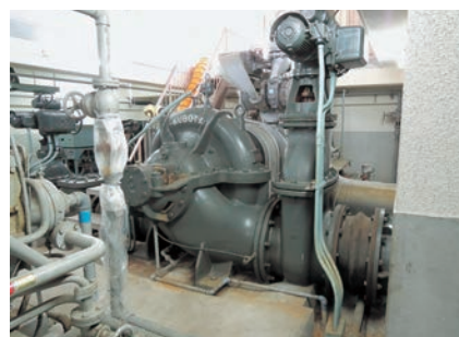
図11 整備前加圧ポンプ装置
