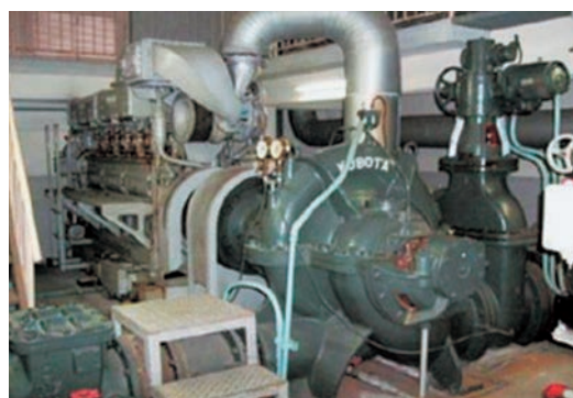
図3 整備前加圧ポンプ装置
