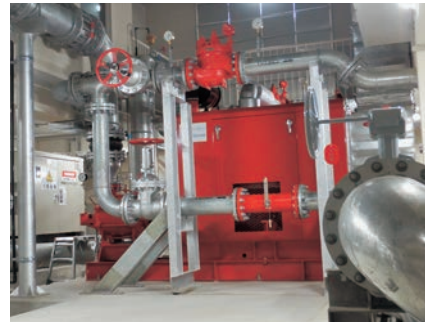
図12 整備後加圧ポンプ装置
