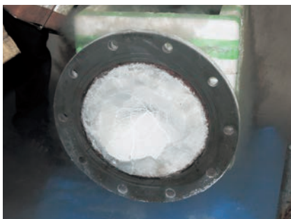
図9 凍結状況拡大1（再使用側配管内部）
