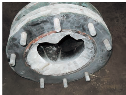
図10 凍結状況拡大2（撤去側配管内部）
