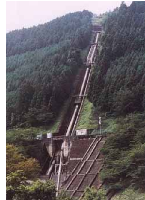
西吉野第一発電所
