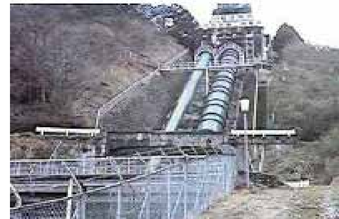
西吉野第二発電所
