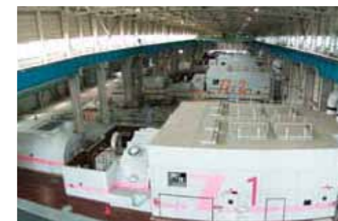
堺港発電所 内部設備
