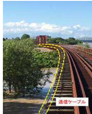
※橋梁上に敷設していたケーブルが河川増水に伴う流木により断線したと推定される。
