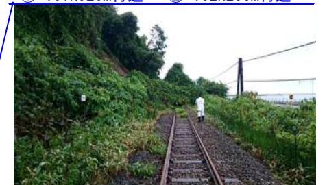
①崩壊延長 L=18m 崩壊土量 V=40m 3 ②崩壊延長 L=20m 崩壊土量 V=140m 3 ※8月25日 復旧見込み
