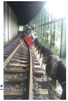
崩壊延長 L=40m 崩壊土量 V=1800m 3 ※復旧工程精査中
