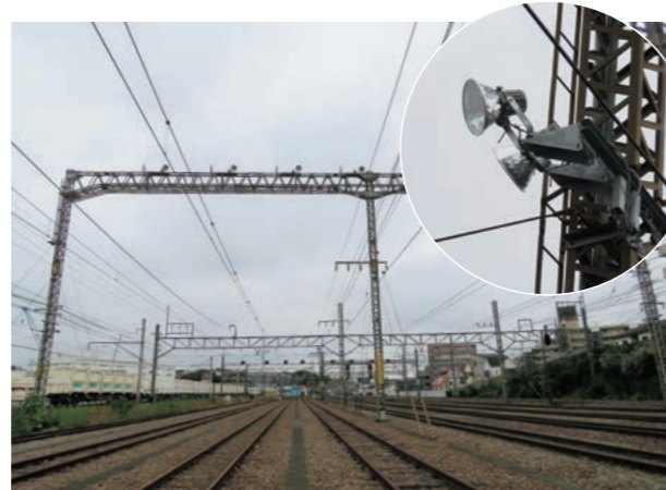
梶ヶ谷貨物ターミナル駅のLED照明
