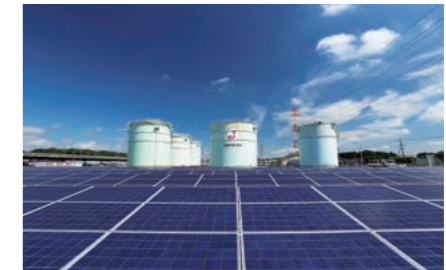
日本オイルターミナル「OT宇都宮メガソーラー発電所」(栃木県河内郡)のソーラーパネル
