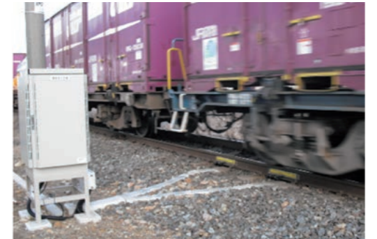
輪重測定装置による測定
