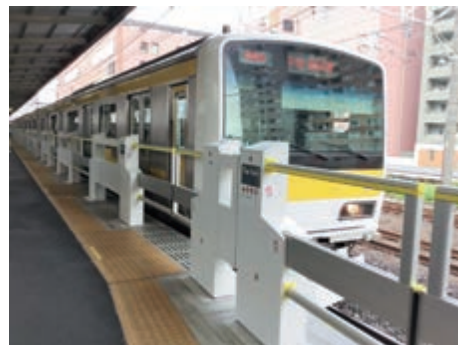
スマートホームドア®(亀戸駅)
