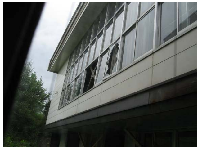
窓ガラス、窓枠損傷 多数
