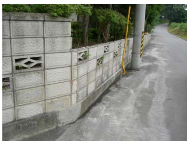
階上町道仏付近 ブロック塀上部 2 段 が崩れた。
