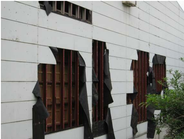
北西側外壁の剥離
