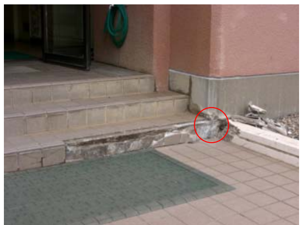
階上町役場南東側通用口の一部損壊 （震度計の南東側約 50m 付近）
