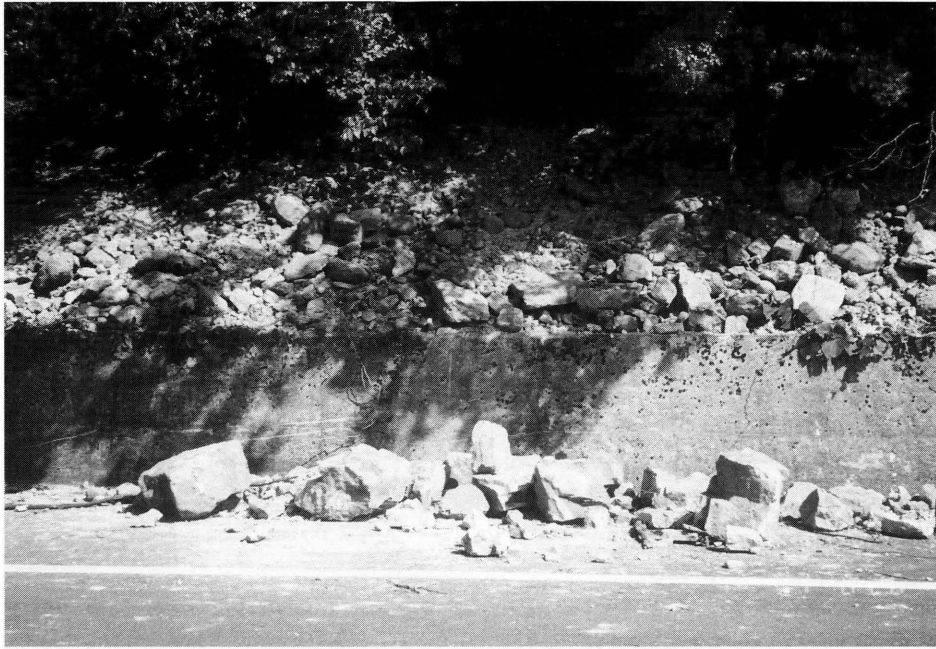
写真-11 県道高佐下 (阿東線と迫田・篠目線との交差点から西へ約40km 入った南斜面) 落石の一部は道路に散乱。
