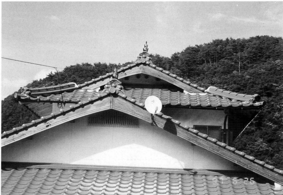
写真-6 正地地区 家の鬼瓦が傾いている。
