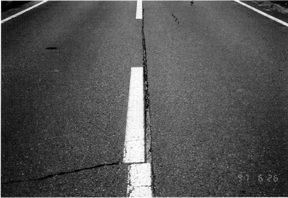
写真-9 県道（迫田・篠目線）田野中付近 道路が南北に4cmずれた。
