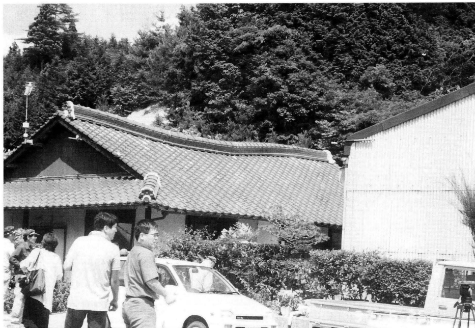
写真-1 田野地区 家の柱や梁が折れ、棟の中心部分がへこんでいる。
