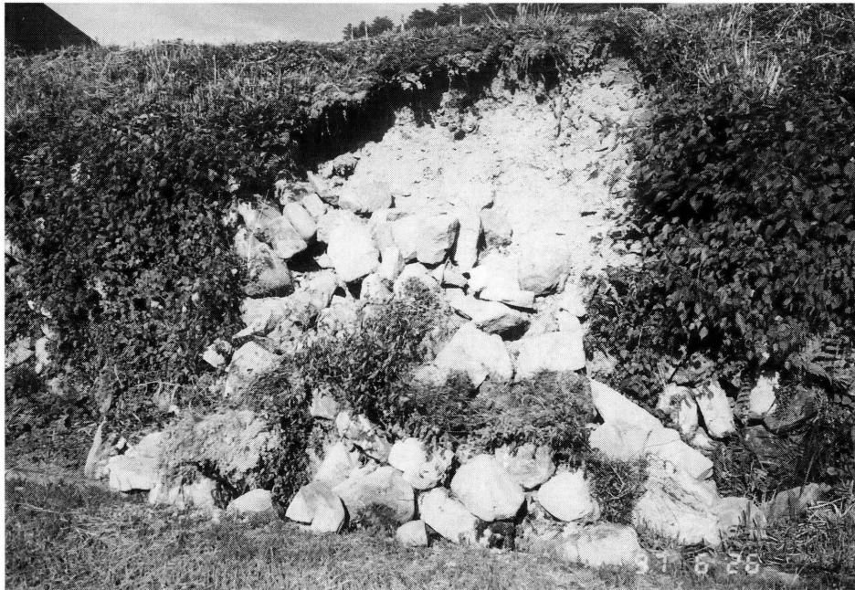
写真-4 田野地区 北側に面したのり面が崩れ落ちた。
