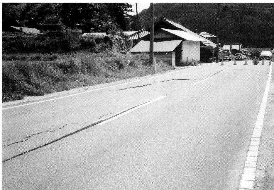
写真-8 県道（迫田・篠目線）の田野中付近 道路のいたる所に亀裂が入り、道路が南北方向に 約4cmずれが生じた。
