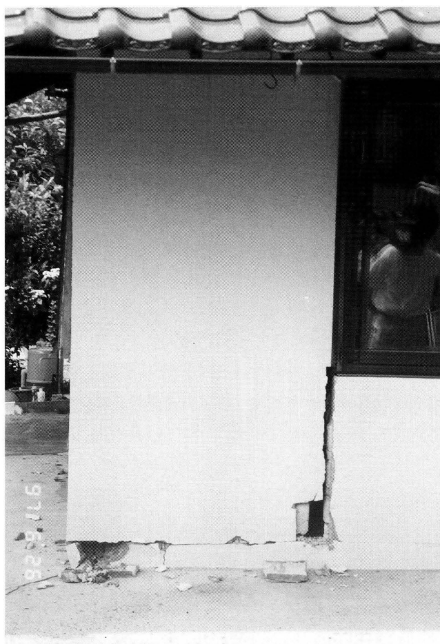
写真-2 田野地区 モルタルの壁の一部が崩れ大きなひびが入る。
