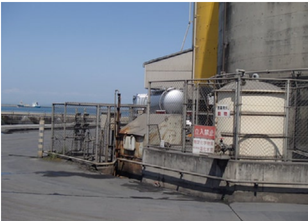
写真7 排水処理管理設備
