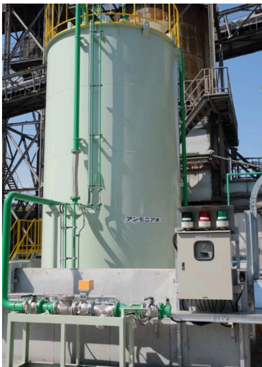
写真8 アンモニア水タンク
