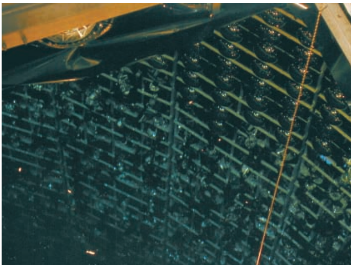
図3 タンク上面から見た被害状況
