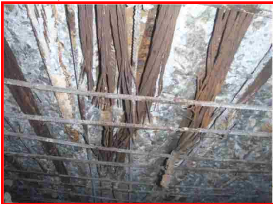
【PCケーブルの損傷状況】
