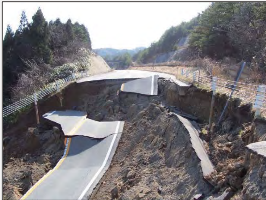
大規模崩壊⑧(鳳珠郡穴水町越の原地内)
