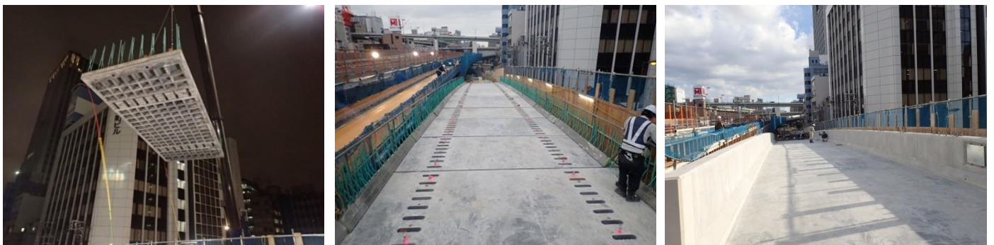
信濃橋入口に適用したワッフル型 UFC 床版 設置状況（左）・設置完了状況（中央）・間詰め及び高欄構築完了状況（右）
