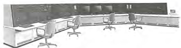
群管理センター監視制御卓
