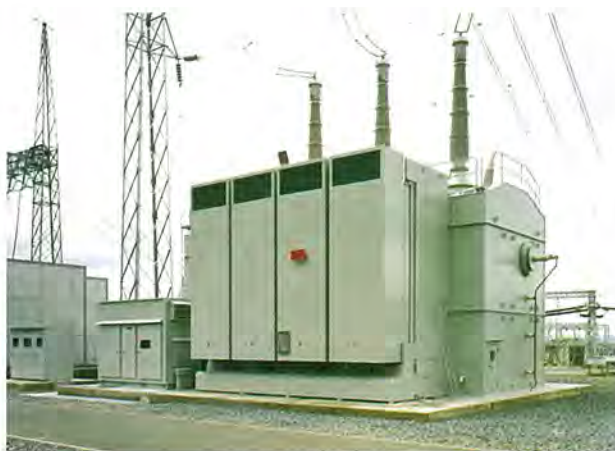
三相275kV, 300MVA 液冷式ガス絶縁変圧器
