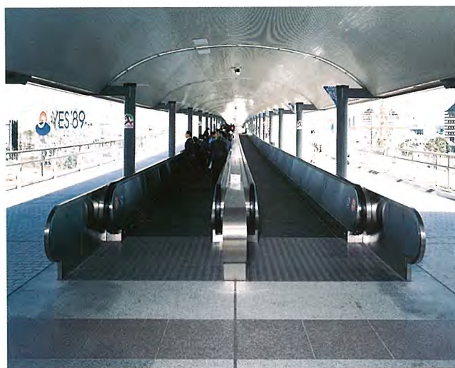
横浜みなとみらい21地区納め1600形トラベーター
