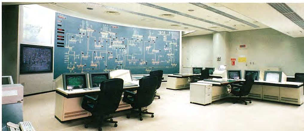
基幹系統給電所
