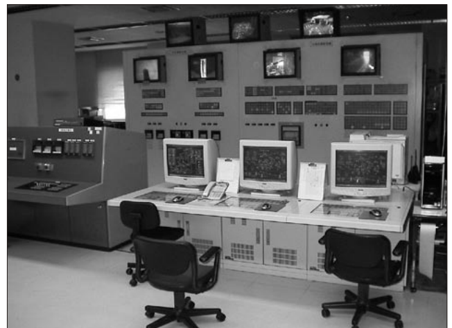
図12 岡崎市中央クリーンセンターの中央制御室
