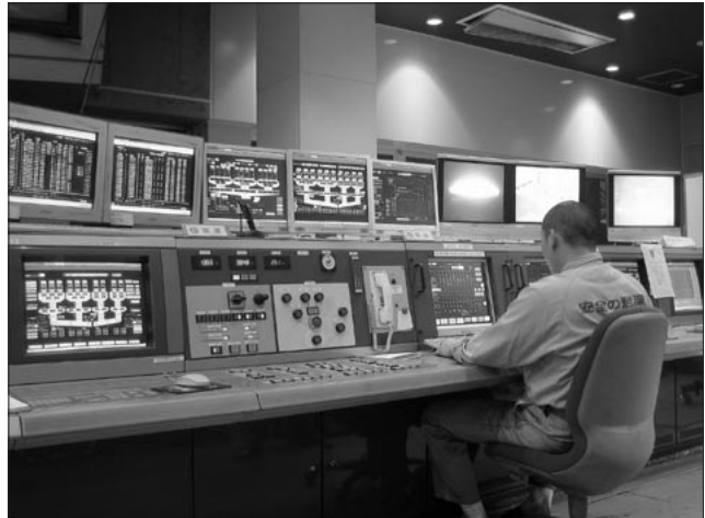
図 14 制御システムの中央操作室
