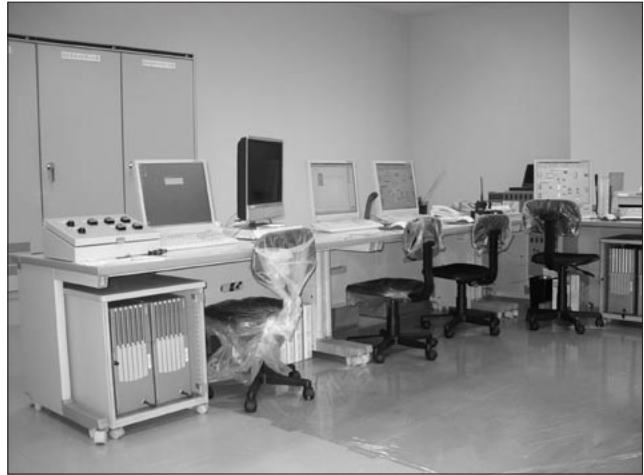
図 13 リサイクルプラントの中央操作室
