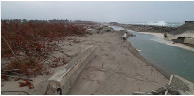
写真1 津波によって破壊された防潮堤
