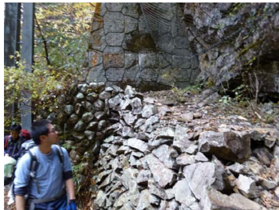
落石防止のネット
