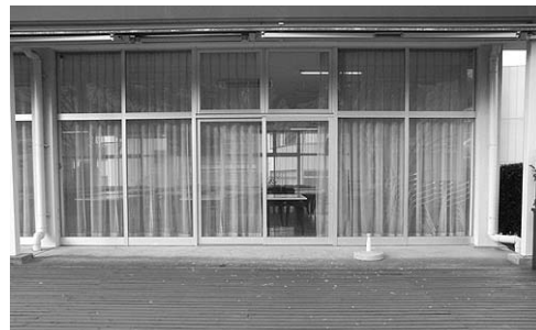
学生食堂のガラスが割れた
