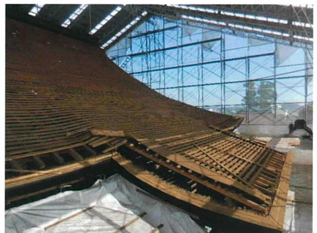
野地木舞の破損状況
