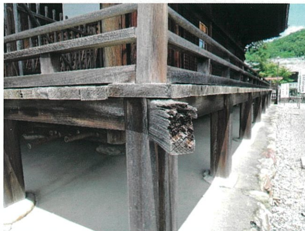
縁廻り破損状況
